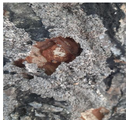
Gambar 7. Kerusakan serangan rayap di jalur hijau
